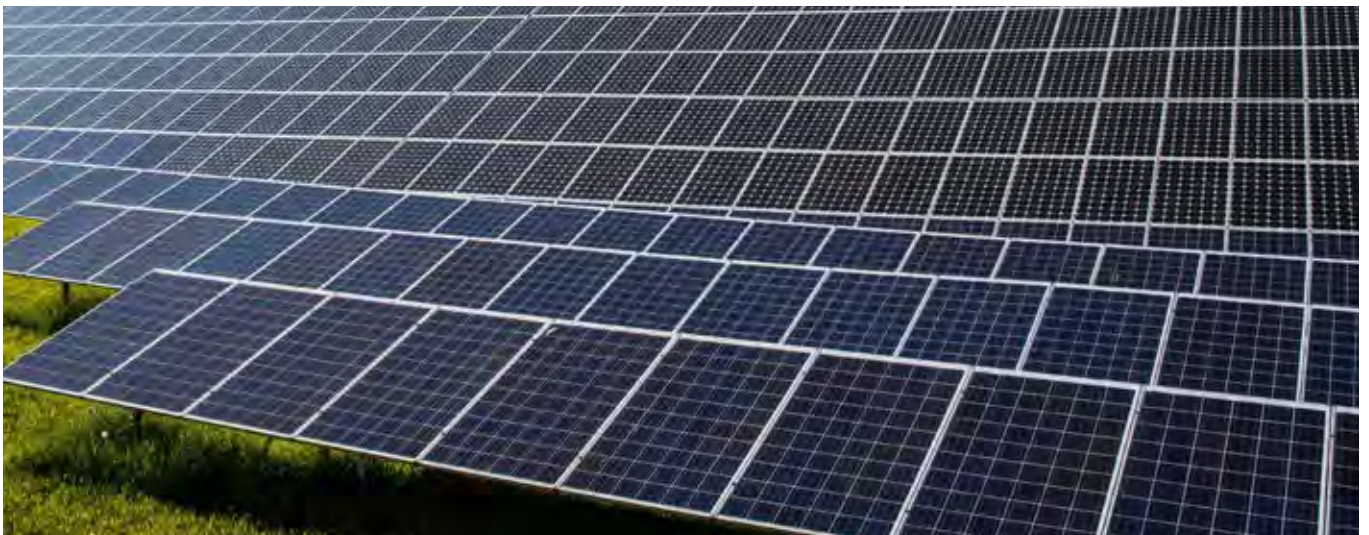
Photovoltaikanlage Quelle: https://www.solar-hausfeld.de/content/impressionen/
